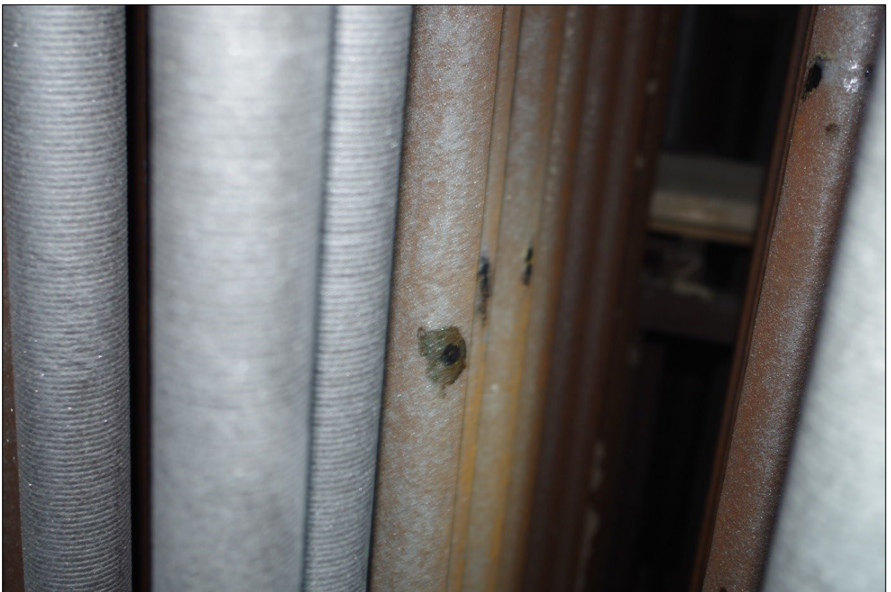
Abbildung 2b: Nach wiederholt kurzer Standzeit der ersten Rohrreihen der Endüberhitzer an einem Standort mit den Dampfparametern 400 °C/40 bar wurden die genannten Rohrreihen durch auftragsgeschweißte Rohre ersetzt. Die Abbildung zeigt die ersten beiden Claddingrohrreihen und die dahinter anschließenden schwarzen Stahlrohre in einem Horizontalzug. Die Standzeit der ersten beiden Reihen betrug vor Umsetzung der Maßnahme drei bis vier Jahre. Das gesamte Bündel kann aktuell voraussichtlich sieben bis acht Jahre betrieben werden. Ein Recycling der gecladdeten Bauteile durch Wiederverwendung ist meist möglich.
