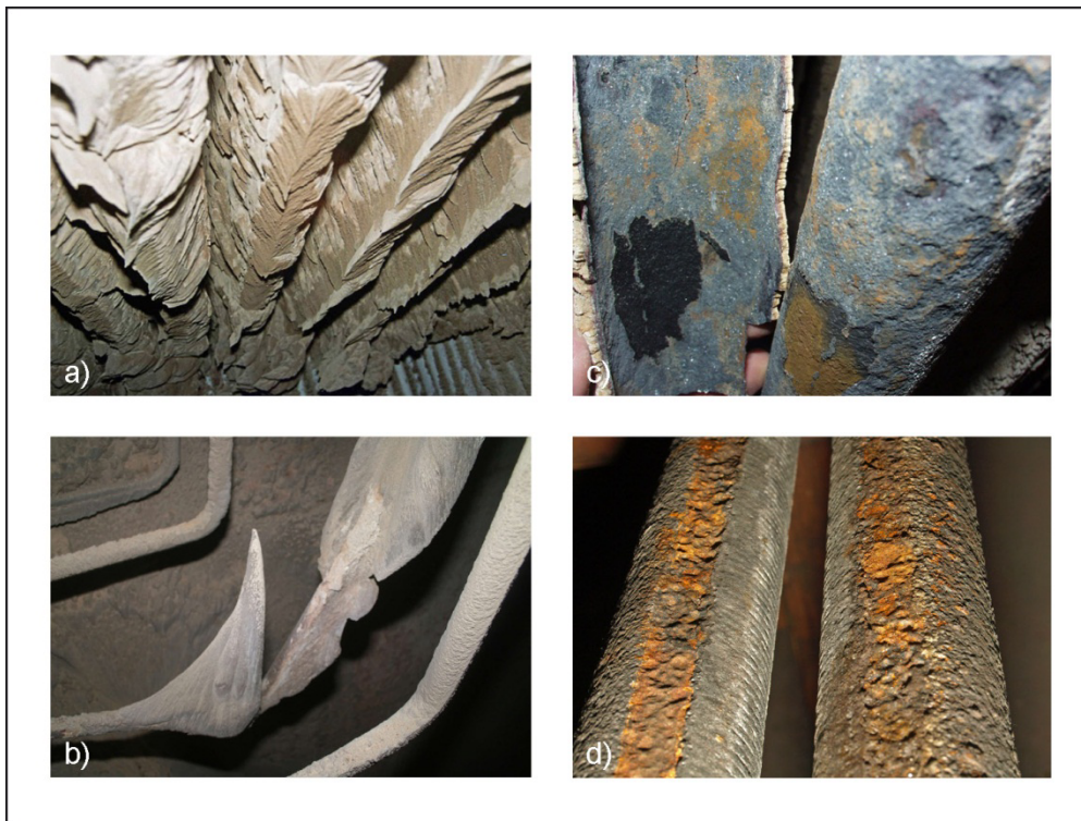
Abb. 4: a) und b) Schichtenaufbau: Rohrwerkstoff – Belag; c) Schichtenaufbau: Rohrwerkstoff – Korrosionsfront – Korrosionsprodukte – Belag; d) Schichtenaufbau: Rohrwerkstoff – Korrosionsfront – Korrosionsprodukte – (Belag)
