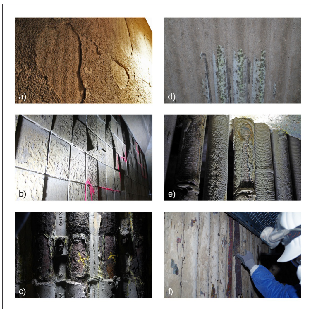
Abb. 1: a) und b) Schichtenaufbau: Rohrwerkstoff – Schutzschicht (Feuerfestzustellung); c) Schichtenaufbau: Rohrwerkstoff – Korrosionsfront - Korrosionsprodukte – Schutzschicht (Feuerfestzustellung); d) und e) Schichtenaufbau: Rohrwerkstoff – Schutzschicht (Cladding) – Korrosionsfront – Korrosionsprodukte – (Belag); f) Schichtenaufbau: Rohrwerkstoff - Korrosionsfront – Korrosionsprodukte – Belag
