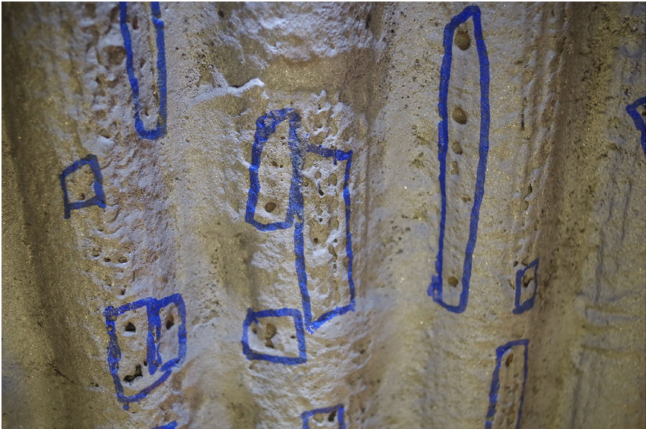
Abbildung 4: Auch stark abgezehrtes Cladding kann durch lokale Reparaturschweißungen wieder instandgesetzt werden, das entstehende Gefüge ist von geringerer Qualität
