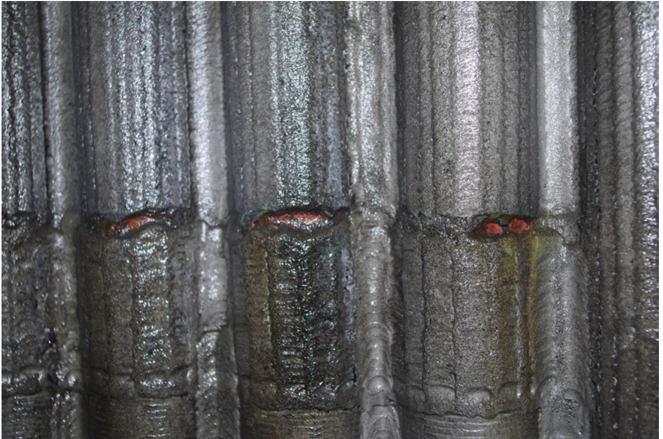
Abbildung 5: An einer horizontalen Verbindungsschweißnaht war lokal das Cladding bis zum Grundwerkstoff und teils auch letztgenannter bis zur Leckage abgezehrt; im Umfeld und auch strahlungsabgewandt war kaum Abzehrung erkennbar
