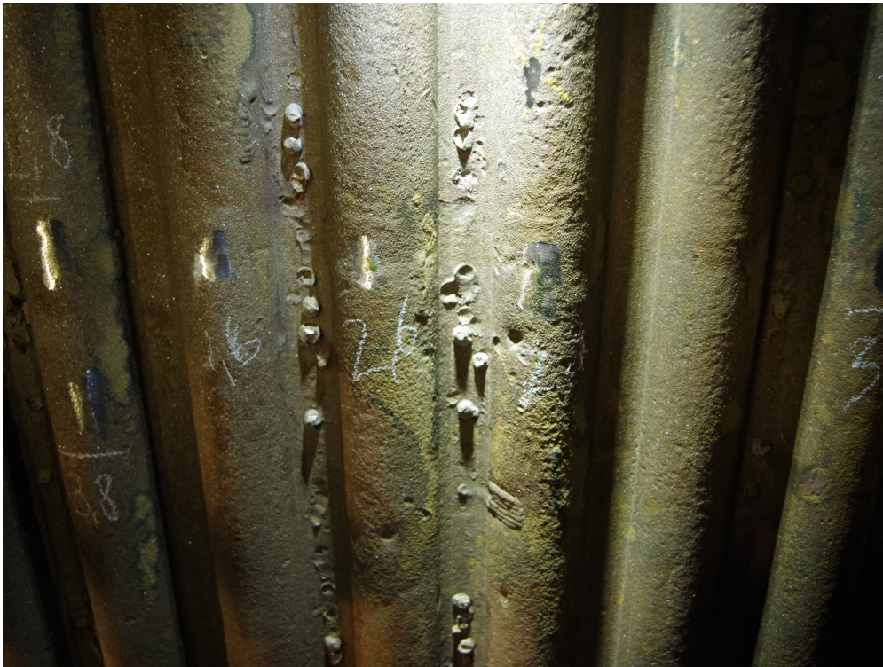
Korrosive Abzehrung unter den Platten
