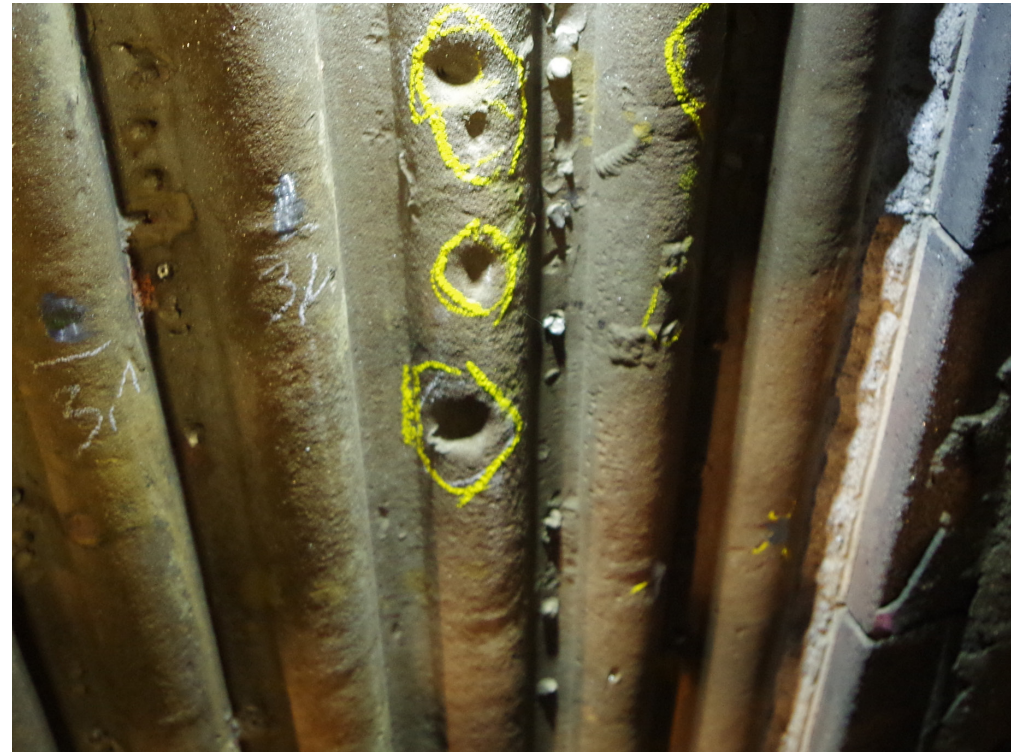
Schlagschäden durch Ausbruchsarbeiten
