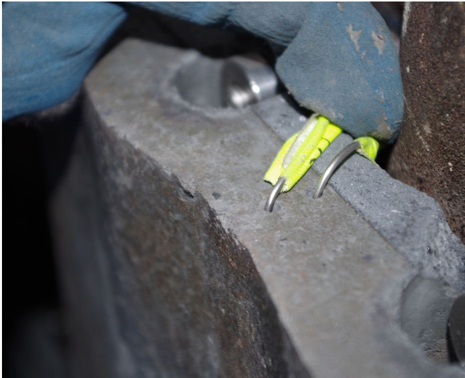
Thermoelemente in hinterlüfteter Platte
